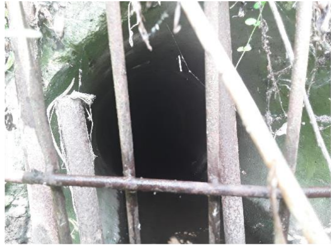
Рис. 6. Раздвижка звеньев трубы. Коррозия металла ограждения.
