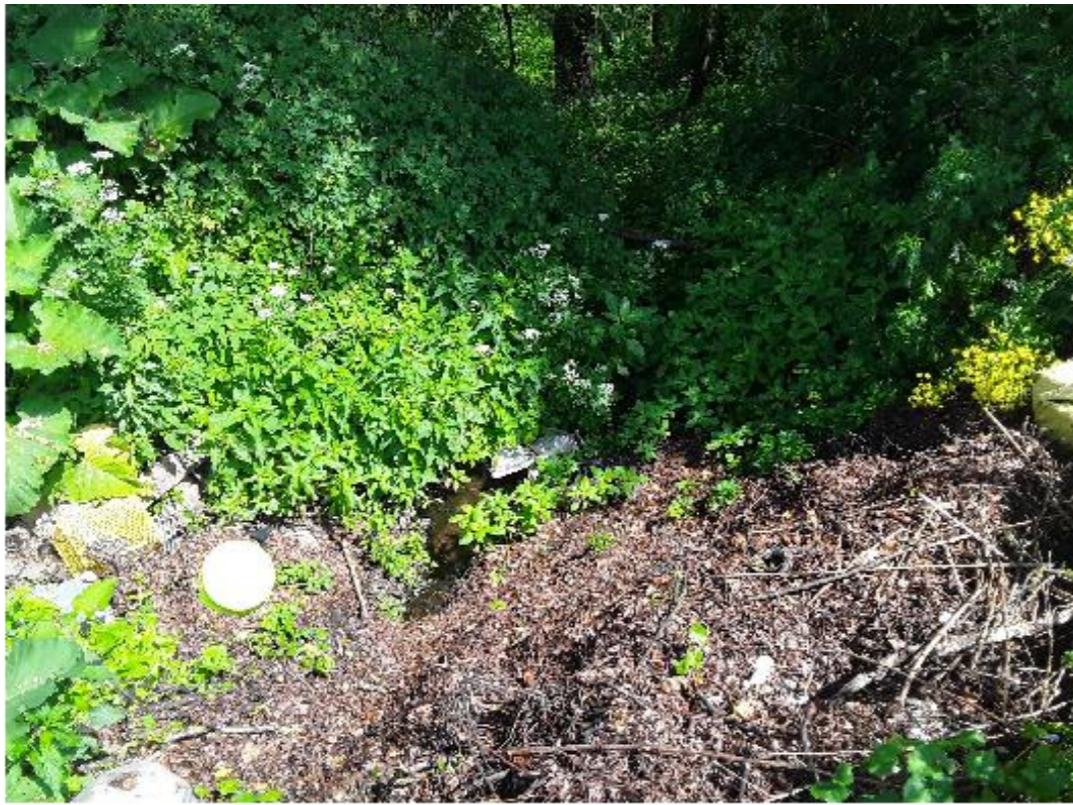
Рис. 5. Общий вид русла со стороны выходного оголовка. Зарастание кустарником русла выходного оголовка. Отсутствие укрепления русла выходного оголовка. Замусоривание русла со стороны выходного оголовка.
