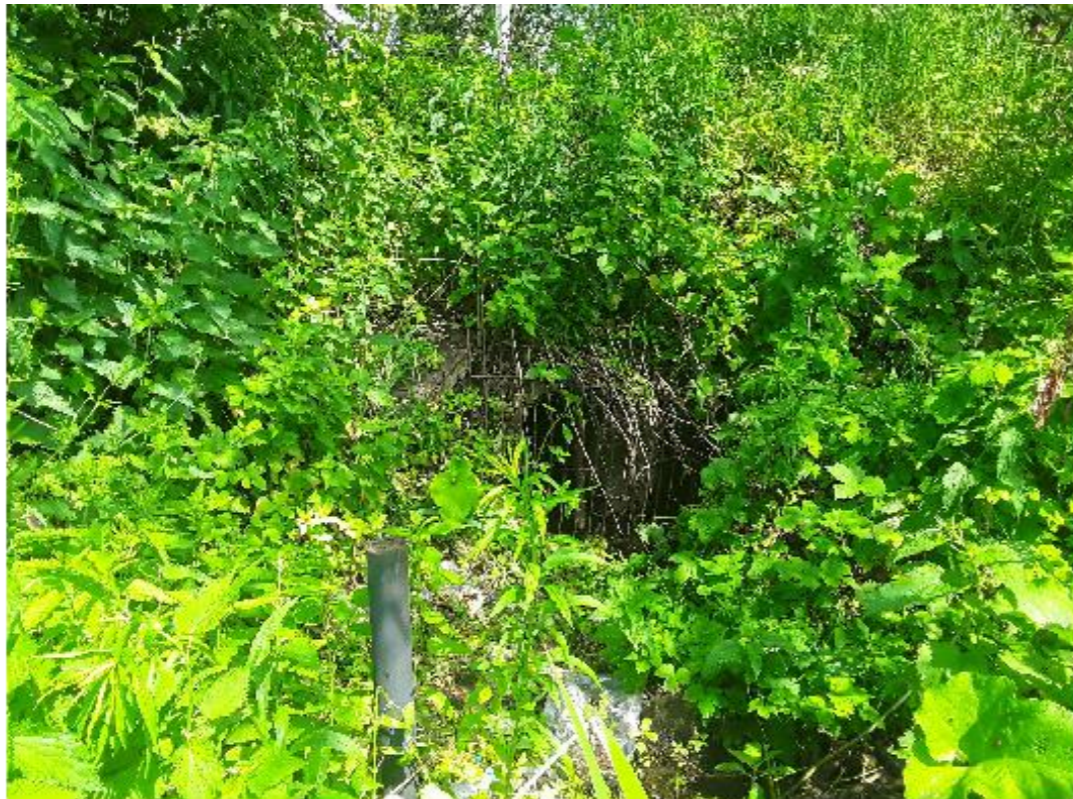
Рис. 3. Общий вид трубы со стороны входного оголовка. Заращение откосов насыпи и отсутствие порталной стенки со стороны входного оголовка. Отсутствие укрепления откосов насыпи со стороны входного оголовка.
