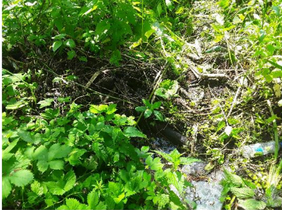
Рис. 1. Общий вид русла со стороны входного оголовка. Заращение и заиливание русла входного оголовка. Отсутствие укрепления русла входного оголовка
