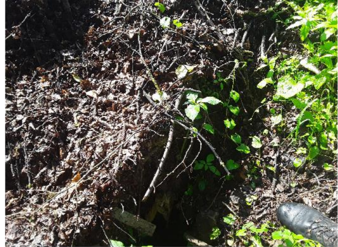
Рис. 2. Общий вид со стороны выходного оголовка. Полная засыпка трубы со стороны выходного оголовка.
