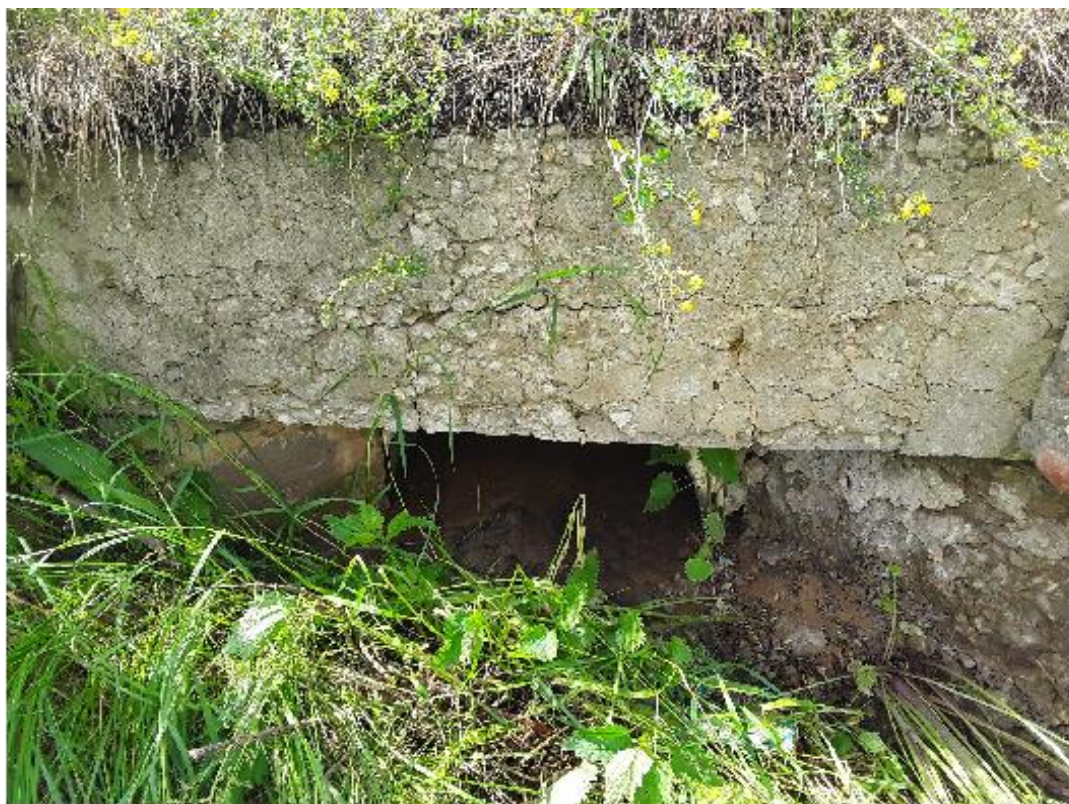
Рис. 9. Трещины на порталной стенке выходного оголовка. Заиливание лотка трубы со стороны выходного оголовка.
