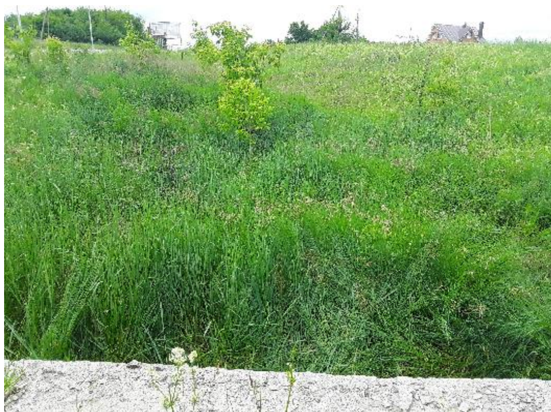
Рис. 5. Общий вид русла со стороны входного оголовка. Заращение русла входного оголовка. Отсутствие укрепления русла входного оголовка.
