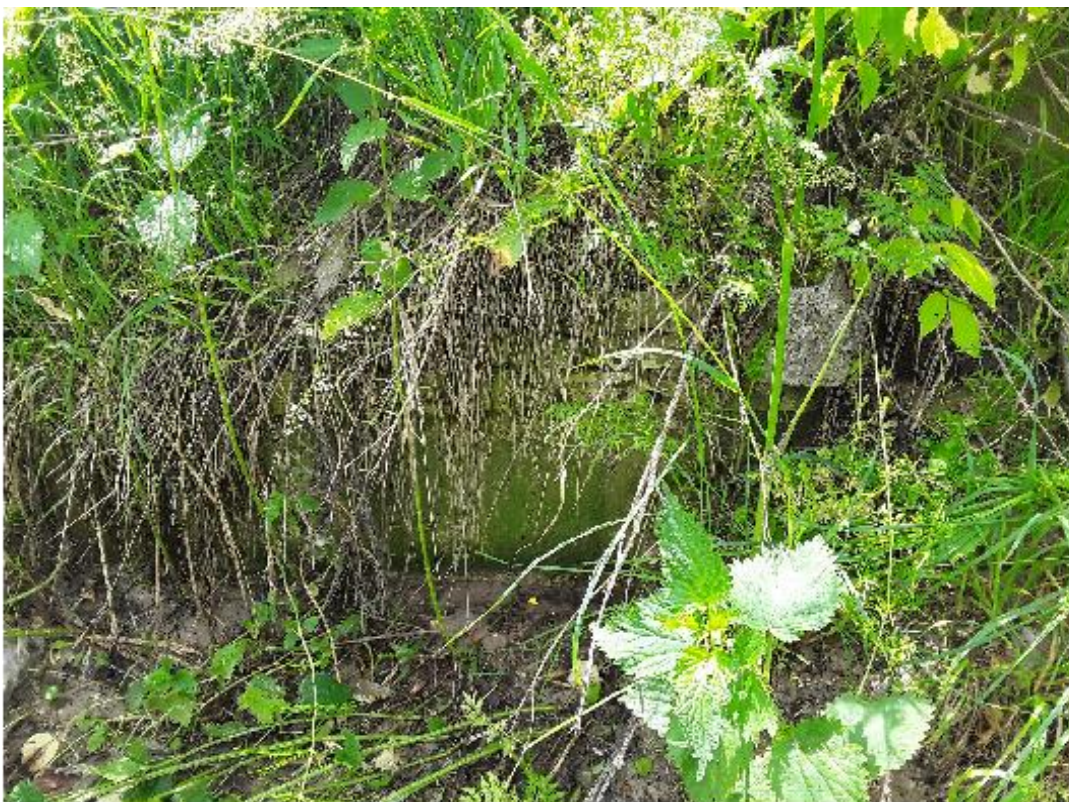
Рис. 11. Разрушение откосных стенок выходного оголовка
