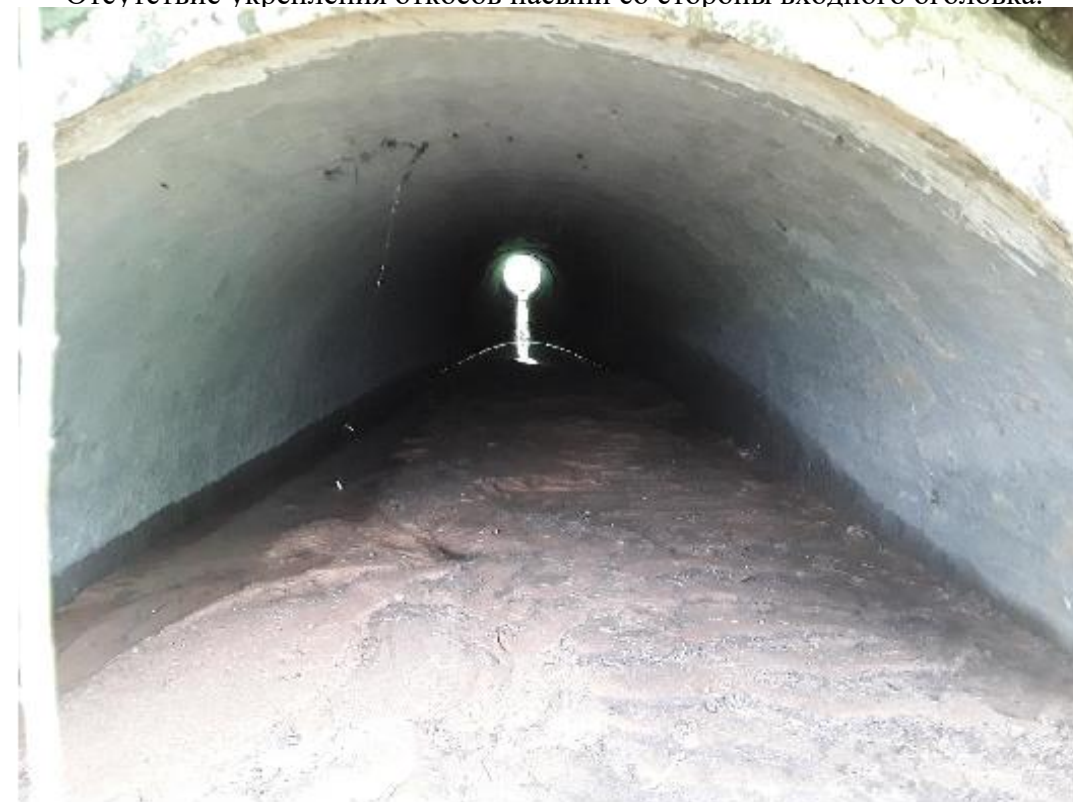
Рис. 12. Общий вид тела трубы со стороны выходного оголовка. Заиливание лотка тела трубы.
