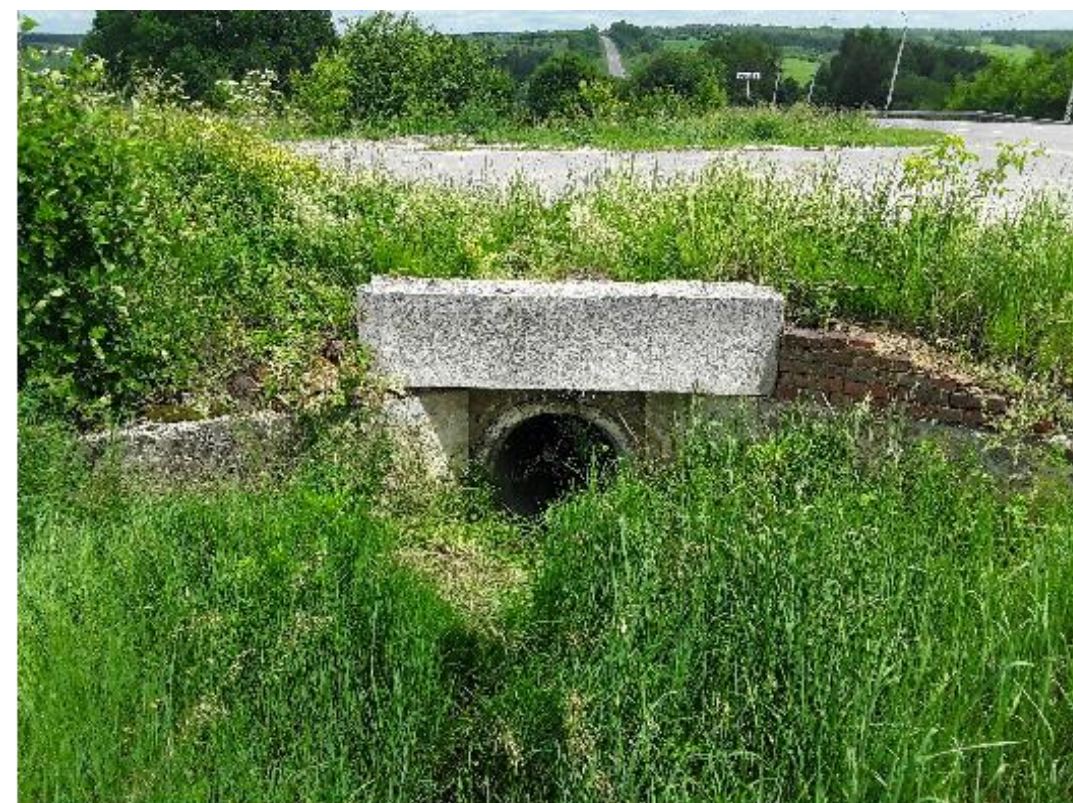
Рис. 6. Общий вид трубы со стороны входного оголовка. Заращение откосов portalной стенки со стороны входного оголовка. Отсутствие укрепления откосов насыпи со стороны входного оголовка.
