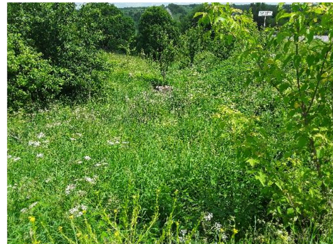
Рис. 6. Общий вид русла со стороны выходного оголовка. Заращение деревьями и кустарником русла выходного оголовка. Отсутствие укрепления русла выходного оголовка.
