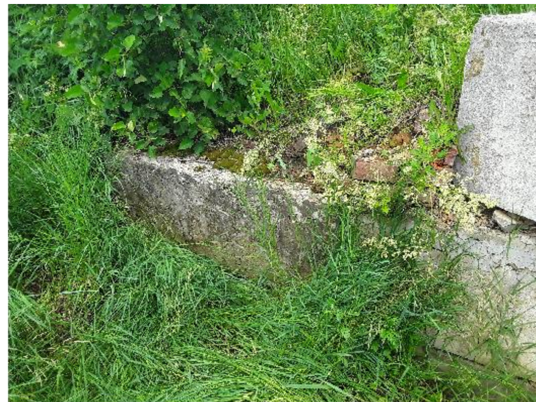
Рис. 10. Разрушение откосных стенок входного оголовка. Заращение откосных стенок со стороны входного оголовка. Отсутствие укрепления откосов насыпи со стороны входного оголовка.
