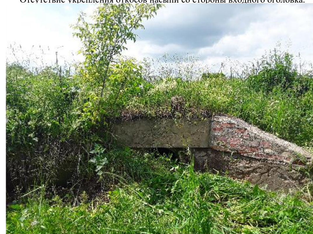
Рис. 8. Общий вид трубы со стороны выходного оголовка. Заращение откосов portalной стенки со стороны выходного оголовка. Отсутствие укрепления откосов насыпи со стороны выходного оголовка.
