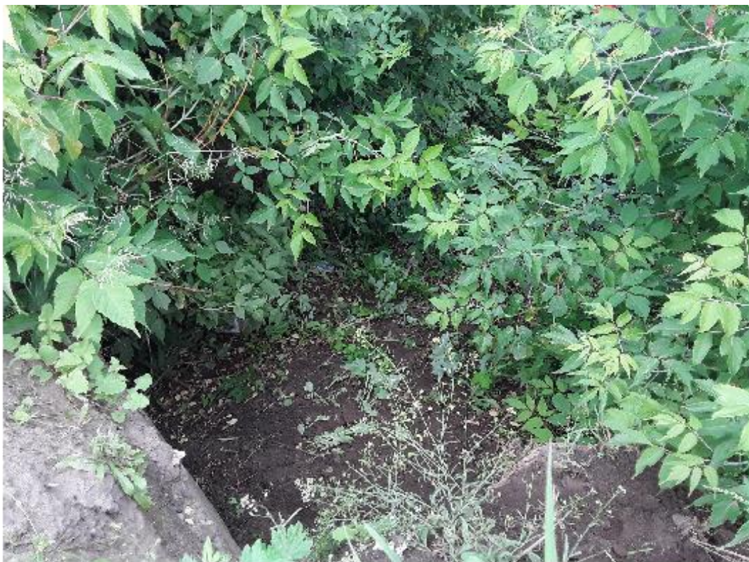
Рис. 5. Общий вид русла со стороны входного оголовка. Заращение кустарником русла входного оголовка. Отсутствие укрепления русла входного оголовка
