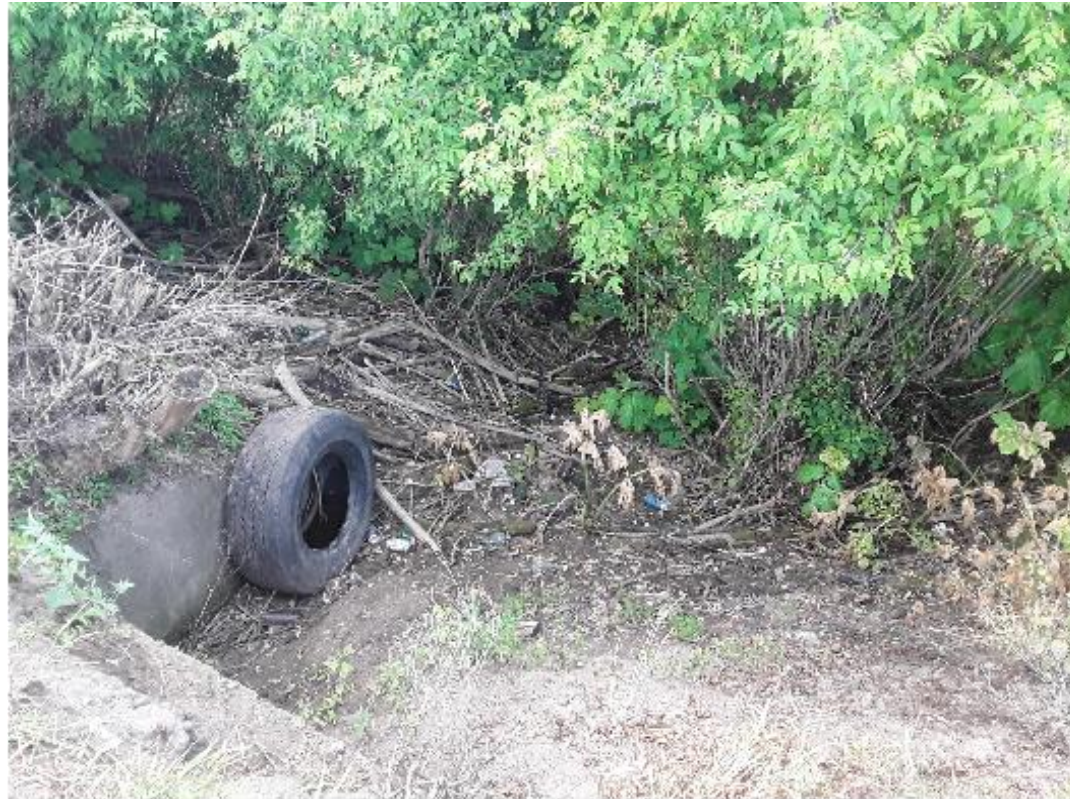
Рис. 1. Общий вид русла со стороны выходного оголовка. Заращение кустарником и порослью деревьев русла выходного оголовка. Отсутствие укрепления русла выходного оголовка Замусоривание русла со стороны выходного оголовка.
