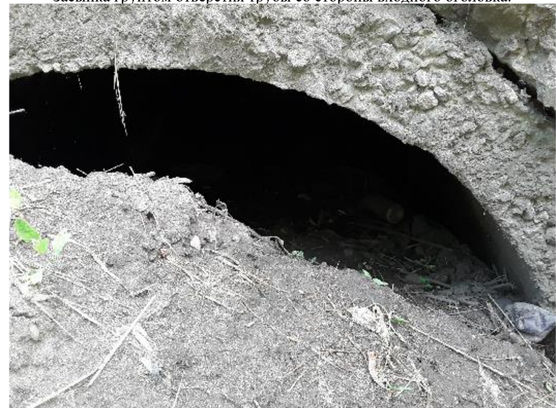
Рис. 4. Засыпка грунтом лотка трубы на выходе более 70%. Образование трещины на соединении звена трубы и portalной стенки со стороны выходного оголовка.
