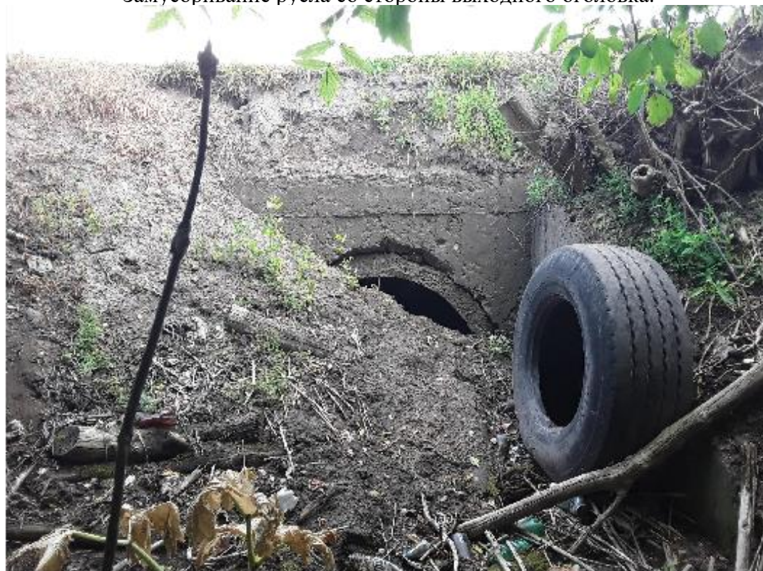
Рис. 3. Общий вид трубы со стороны выходного оголовка. Засыпка грунтом отверстия трубы со стороны выходного оголовка более 70%. Отсутствие укрепления откосов насыпи со стороны выходного оголовка. Заращение кустарником откосов насыпи со стороны выходного оголовка.
