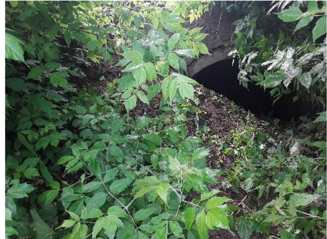
Рис. 2. Общий вид трубы со стороны входного оголовка. Заращение откосов насыпи со стороны входного оголовка. Отсутствие укрепления откосов насыпи со стороны входного оголовка. Засыпка грунтом отверстия трубы со стороны входного оголовка.
