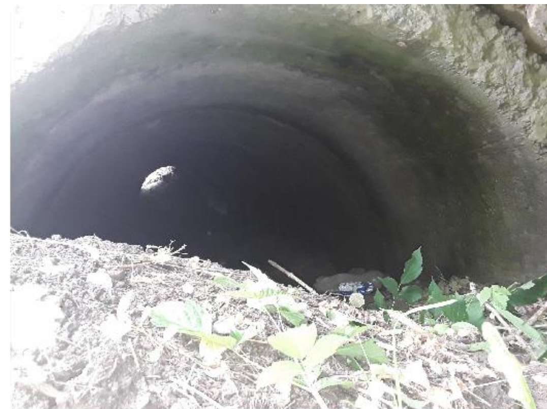
Рис. 10. Заиливание тела трубы. Отверстие в железобетонной стенке звена трубы. Образование трещины на соединении звена трубы и порталной стенки.
