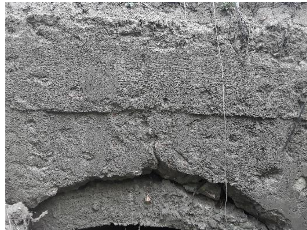
Рис. 12. Трещина на порталной стенке выходного оголовка. Образование трещины на соединении звена трубы и порталной стенки со стороны выходного оголовка. Следы от опалубки на бетонной поверхности порталной стенки.
