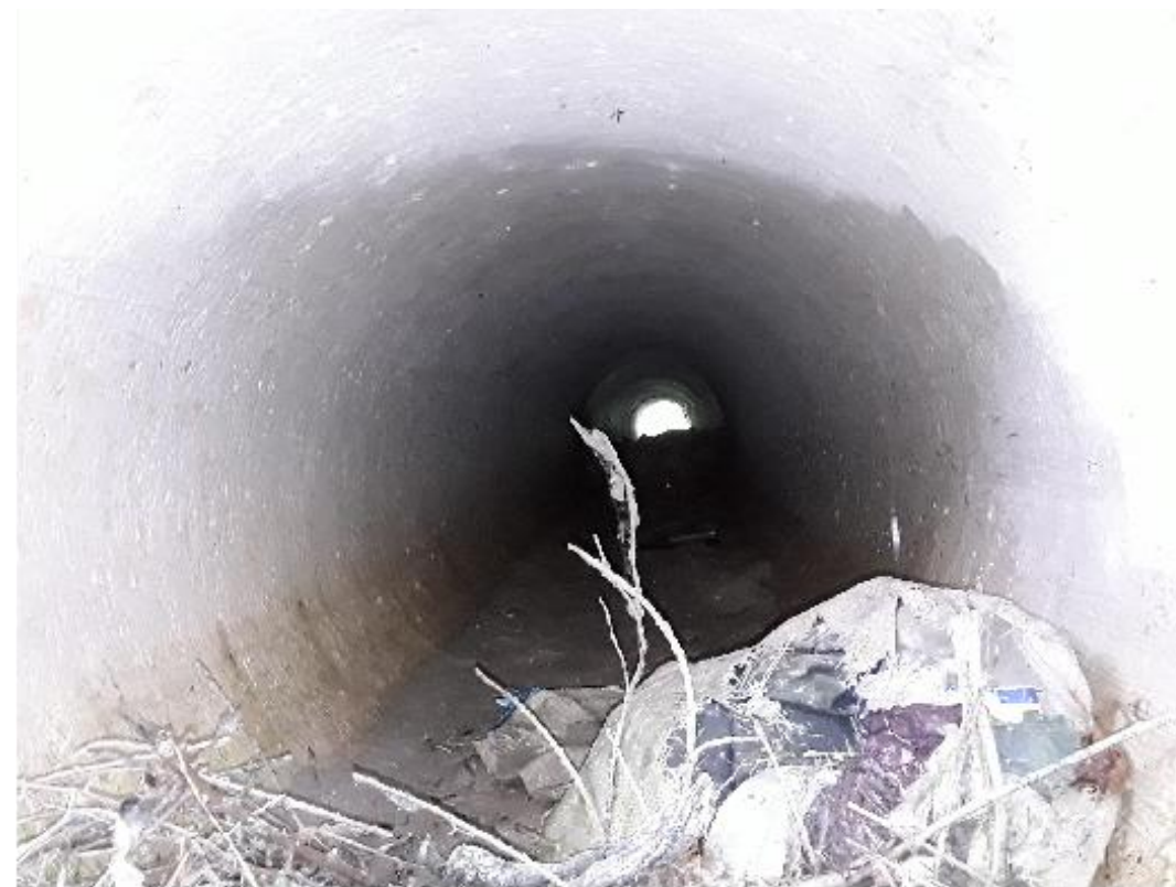
Рис. 10. Общий вид тела трубы. Раздвижка звеньев с просыпанием грунта в тело трубы. Заиливание и наличие бытового мусора в теле трубы.
