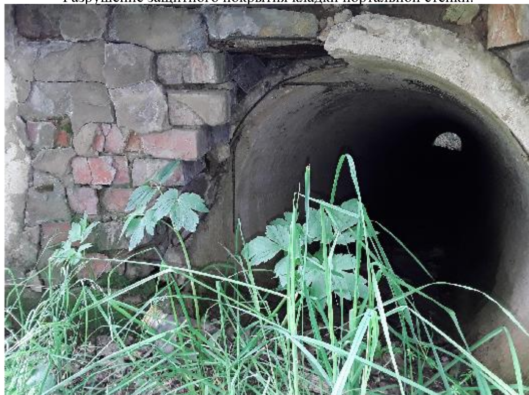
Рис. 11. Скол крайнего звена на выходе с оголением арматуры. Разрушение кладки порталной стенки. Заиливание лотка трубы со стороны выходного оголовка.
