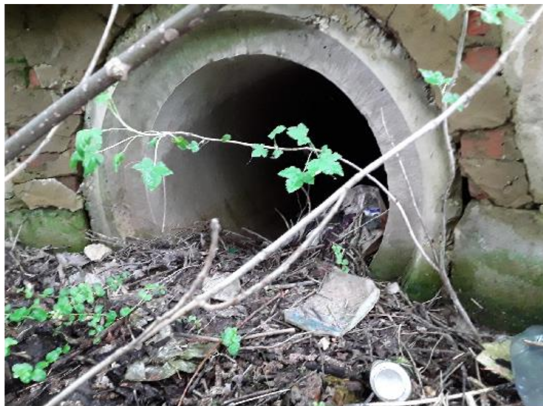
Рис. 9. Заиливание и замусоривание лотка трубы со стороны входного оголовка. Образование зазора между стенками трубы и порталной стенкой. Разрушение защитного покрытия кладки порталной стенки.
