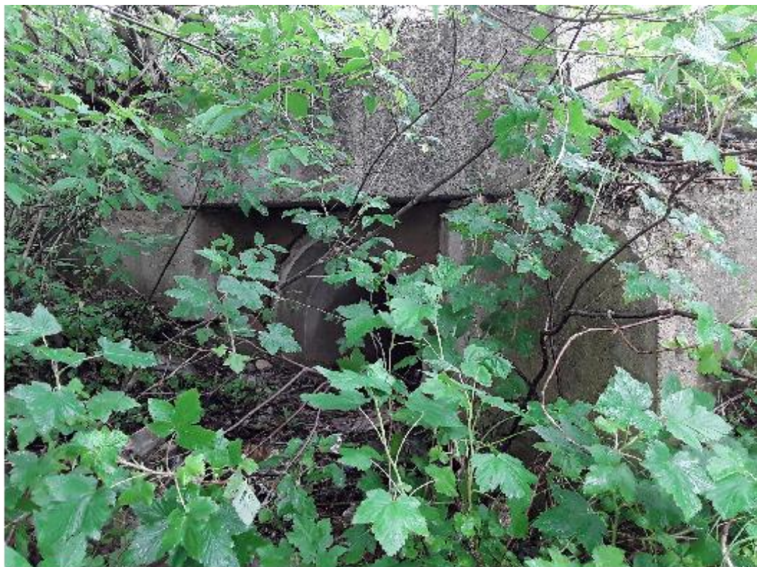
Рис. 5. Общий вид трубы со стороны входного оголовка. Заращение откосов portalной стенки со стороны входного оголовка. Отсутствие укрепления откосов насыпи со стороны входного оголовка.
