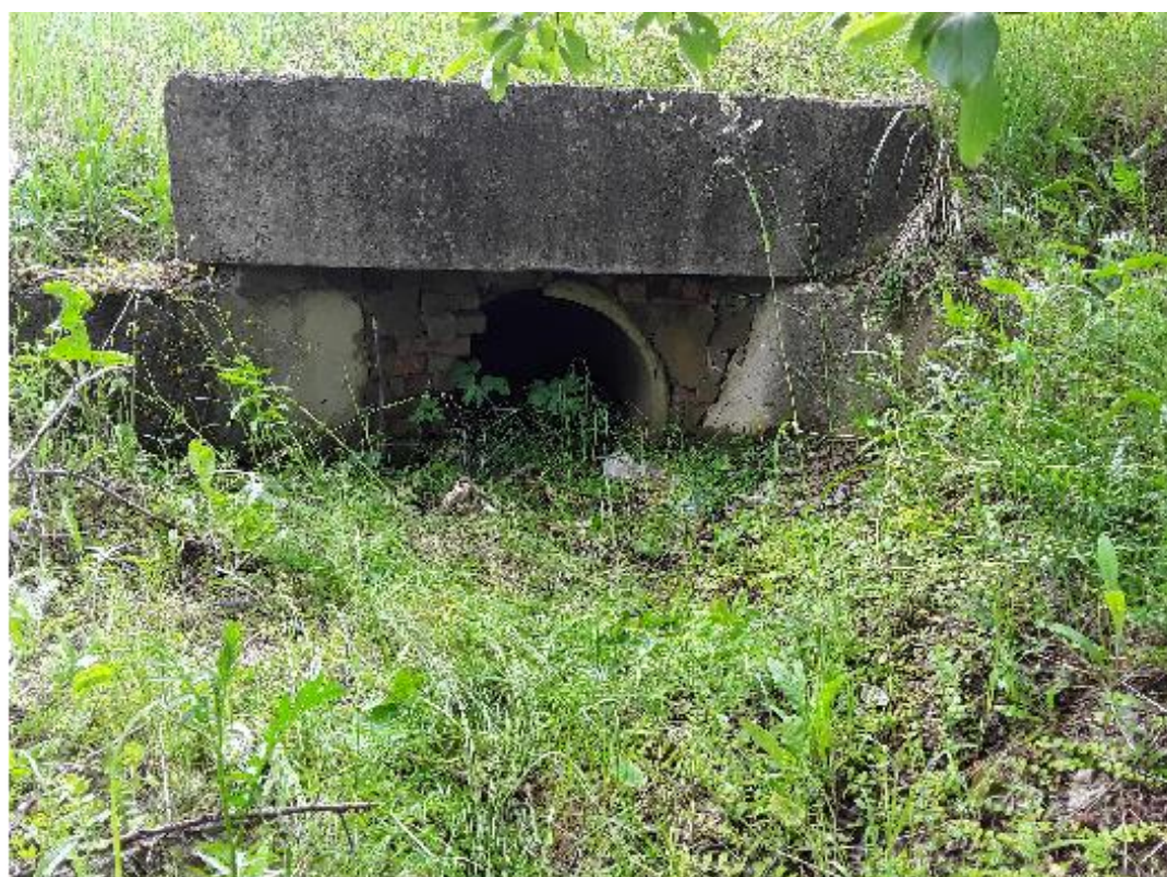
Рис. 7. Общий вид трубы со стороны выходного оголовка. Заращение откосов насыпи со стороны выходного оголовка. Отсутствие укрепления откосов насыпи со стороны выходного оголовка.
