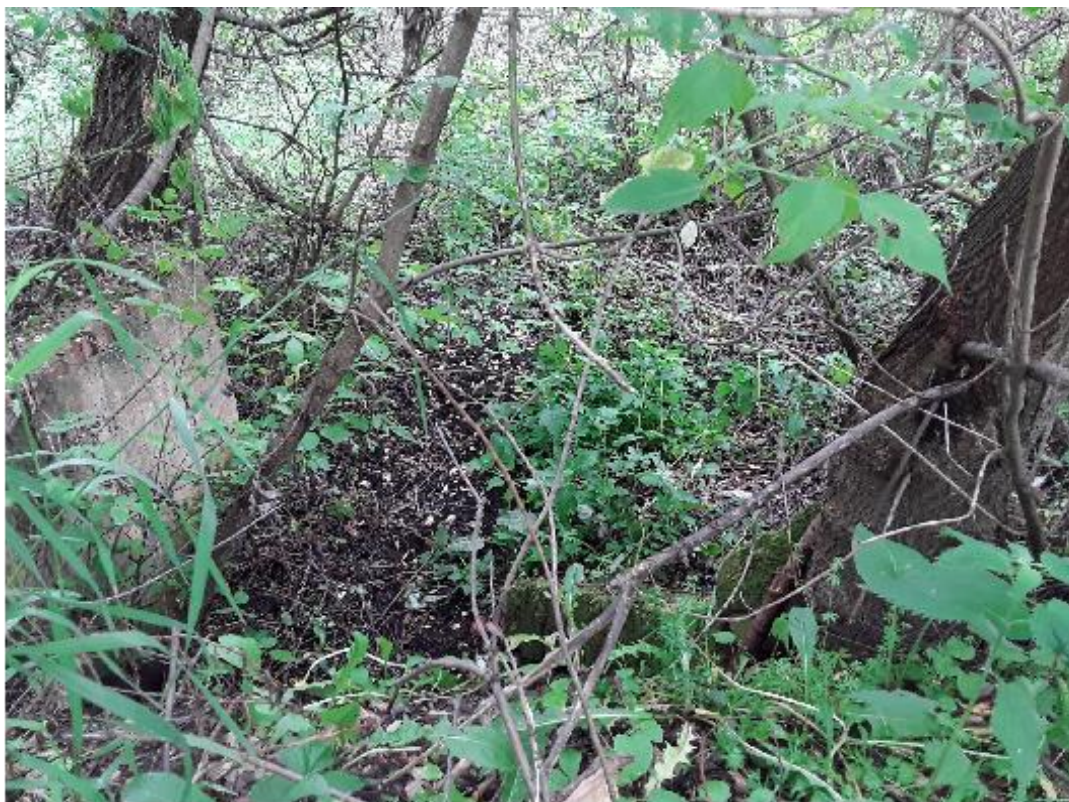
Рис. 5. Общий вид русла со стороны входного оголовка. Заращение деревьями и кустарником русла входного оголовка. Отсутствие укрепления русла входного оголовка.
