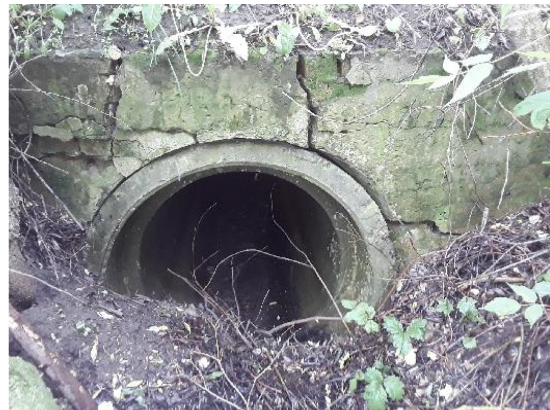
Рис. 10. Разрушение кладки портальной стенки со стороны входного оголовка. Заиливание лотка трубы со стороны входного оголовка.
