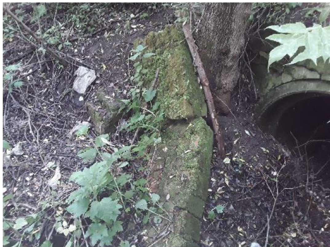
Рис. 9. Обвал левой откосной стенки со стороны входного оголовка. Заращение портальной стенки со стороны входного оголовка.
