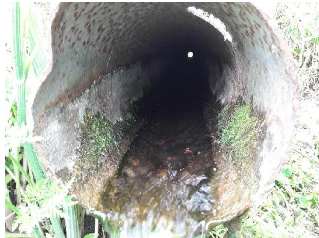
Рис. 10. Общий вид трубы. Образование коррозии стенок трубы, истончение. Заи́ливание лотка трубы. Деформация стенок трубы.
