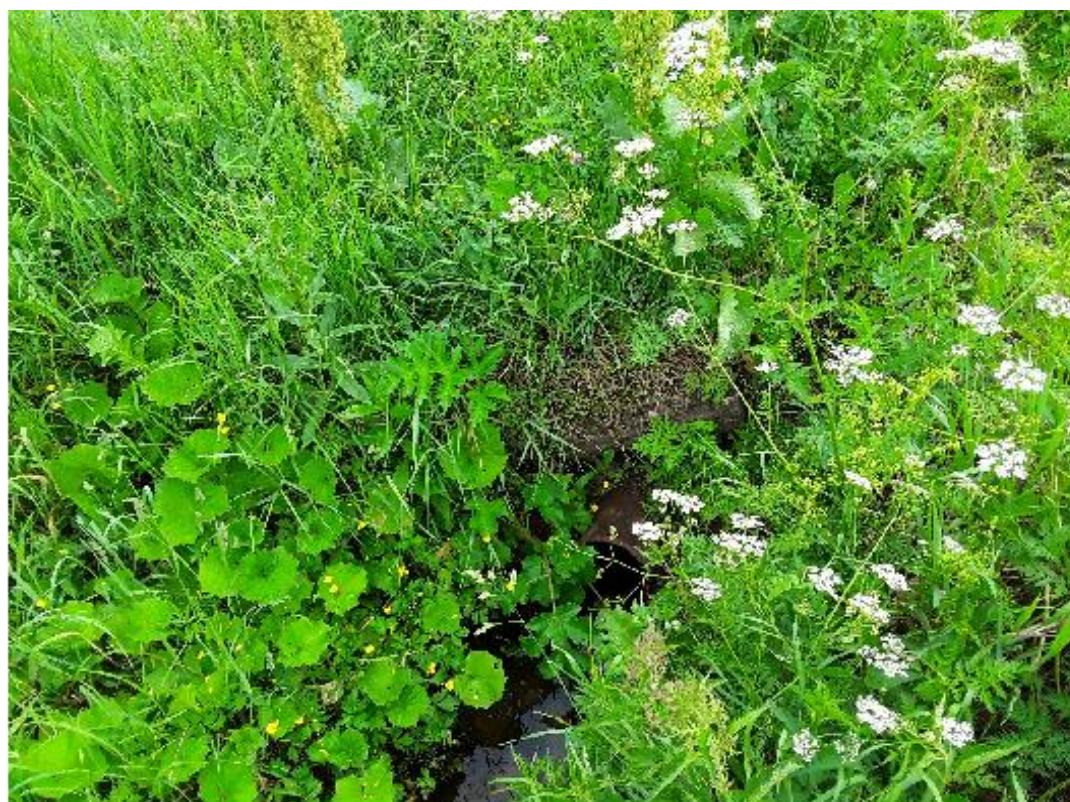
Рис. 7. Общий вид трубы со стороны входного оголовка. Отсутствие порталной стенки со стороны входного оголовка. Отсутствие укрепления откосов насыпи со стороны входного оголовка.
