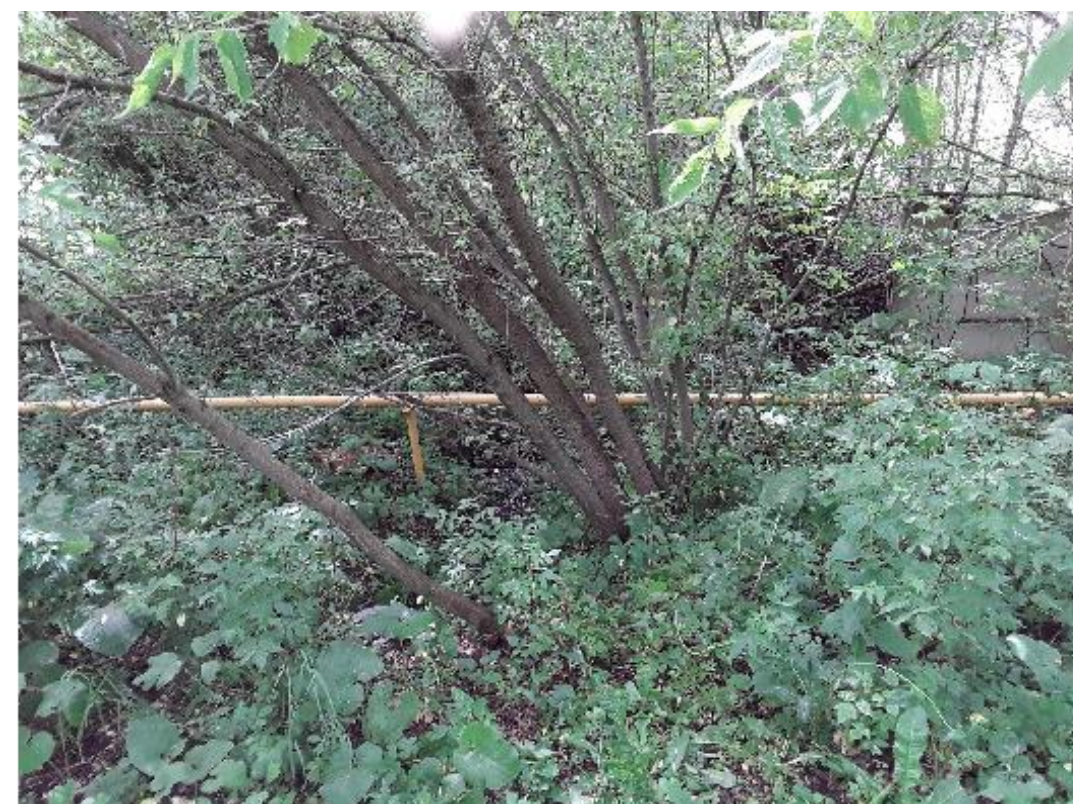
Рис. 8. Общий вид русла со стороны выходного оголовка. Заращение деревьями и кустарником русла выходного оголовка. Отсутствие укрепления русла выходного оголовка. Наличие коммуникация в русле со стороны выходного оголовка.
