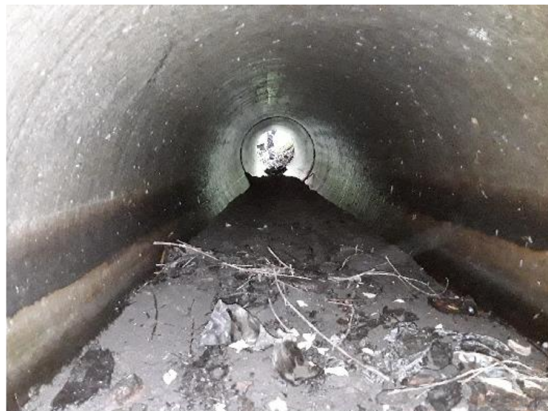
Рис. 4. Заиливание лотка трубы. Разрушение шва между звеньями с просыпанием грунта.
