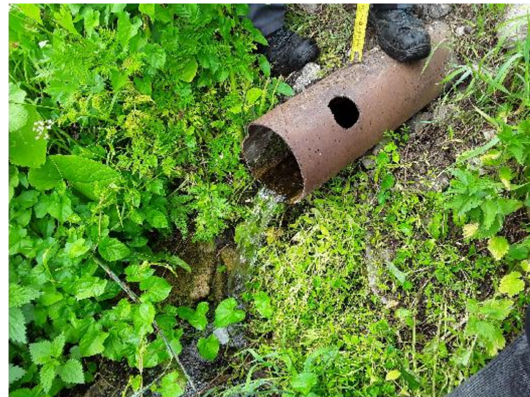
Рис. 6. Общий вид трубы со стороны выходного оголовка. Отсутствие порталной стенки со стороны выходного оголовка. Отсутствие укрепления откосов насыпи со стороны выходного оголовка. Образование коррозии стенок трубы.
