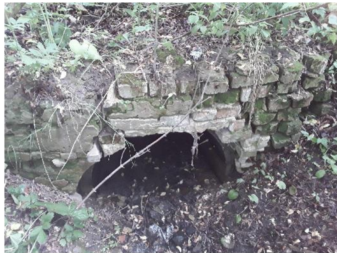
Рис. 11. Разрушение кладки портальной стенки выходного оголовка. Отсутствие укрепления откосов насыпи. Заиливание лотка трубы со стороны выходного оголовка.
