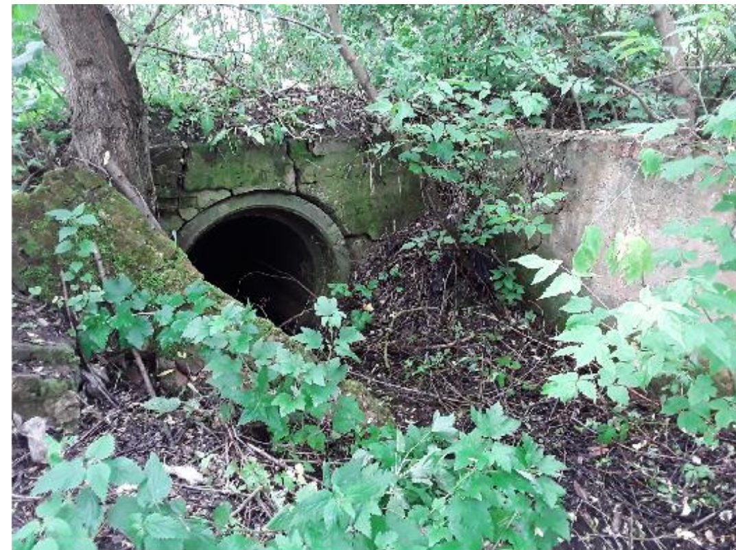
Рис. 6. Общий вид трубы со стороны входного оголовка. Заращение откосов порталной стенки со стороны входного оголовка. Отсутствие укрепления откосов насыпи со стороны входного оголовка.
