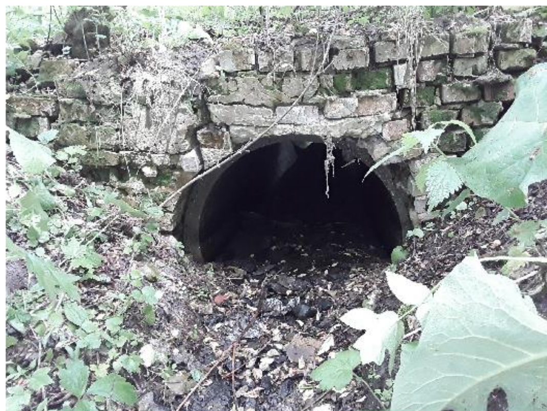
Рис. 7. Общий вид трубы со стороны выходного оголовка. Заращение откосов порталной стенки со стороны выходного оголовка. Отсутствие укрепления откосов насыпи со стороны выходного оголовка. Заиливание лотка трубы со стороны выходного оголовка.
